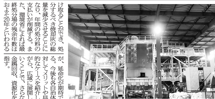
稼働した自社仕様の金銀滓回収プラント
