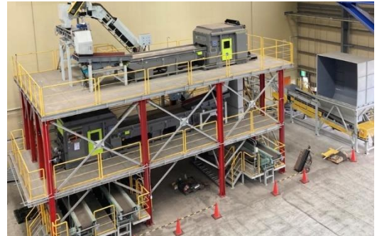
(エコネコル富士工場に設置した選別機)
