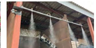
工場内の粉塵対策の実施
