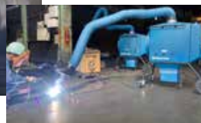
工場内の粉塵対策の実施
