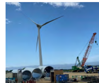
風力発電施設
