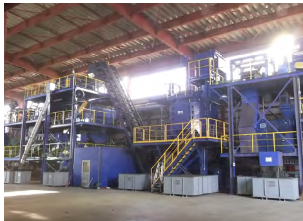
ASR再資源化工場
