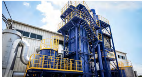
富士宮工場環境設備
