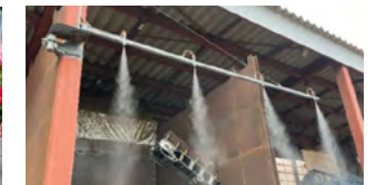
工場内の粉塵対策の実施
