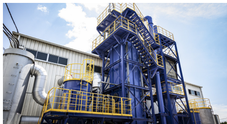
富士宮工場環境設備
