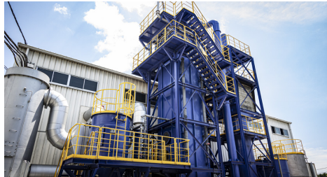
富士宮工場環境設備
